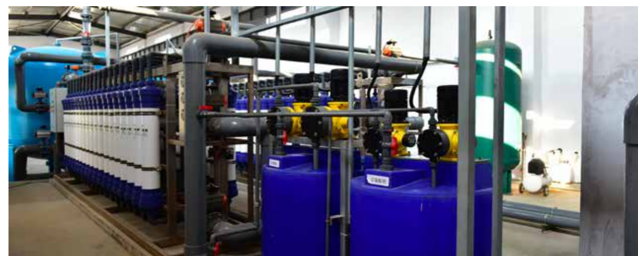
焦家金矿中水处理设施
