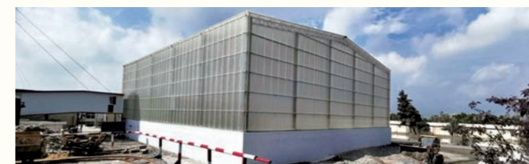
地表矿石钢结构堆棚
