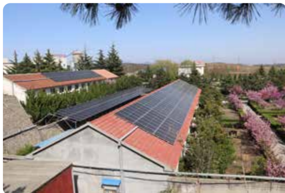
光伏发电项目
