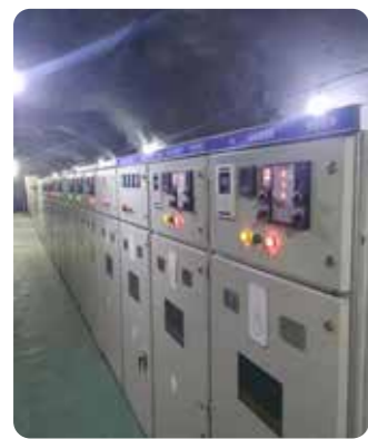
白音呼布矿业公司自动化配电系统
