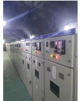
自动化配电系统
