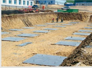
2018年5月23日选厂办公室及化验室开挖基础土方，进入工程施工阶段。
