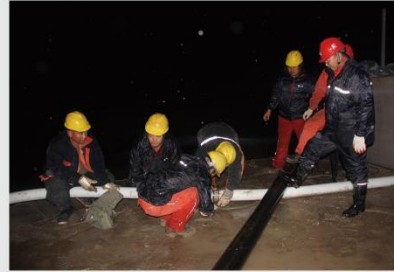
2018年9月27日，雨夜抢修管路，经过6个小时的奋战，圆满完成抢修任务
