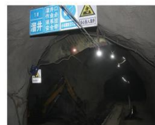
主溜井卸载站
