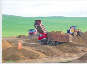
2017年8月1日2000t/d选厂开工建设，迎风飘扬的橘色旗帜，热火朝天的施工现场
