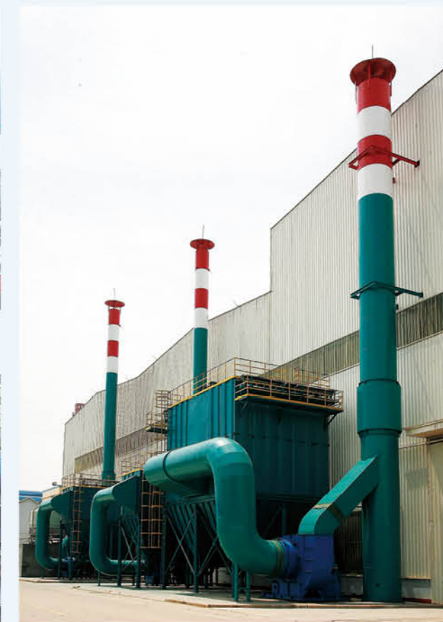
再生与浇注冷却除尘系统 Regeneration and pouring cooling dust-removal system
