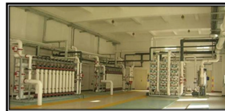
超滤装置和反渗透装置
