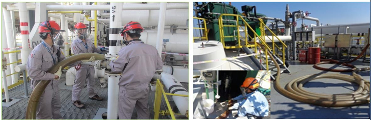
图 3.2-4 检修时废气软管收集设施
