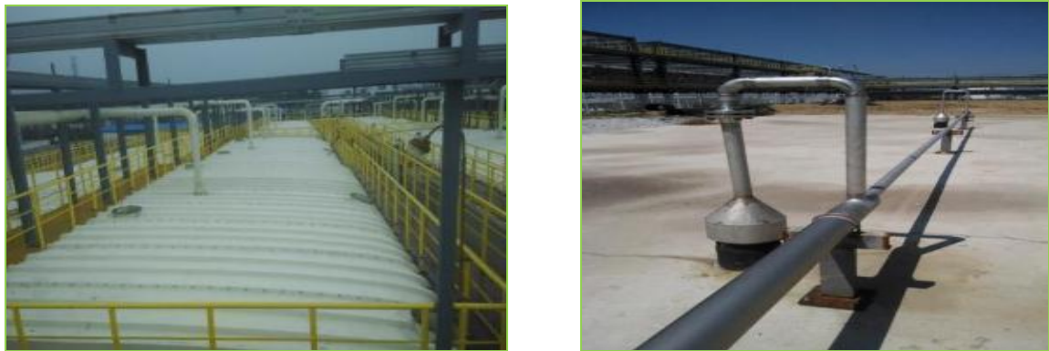
图 3.2-6 污水处理系统、污水池废气收集设施
