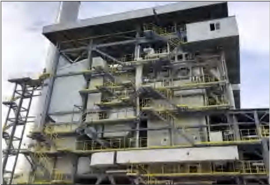
图 2.2-2 废能锅炉外貌图
