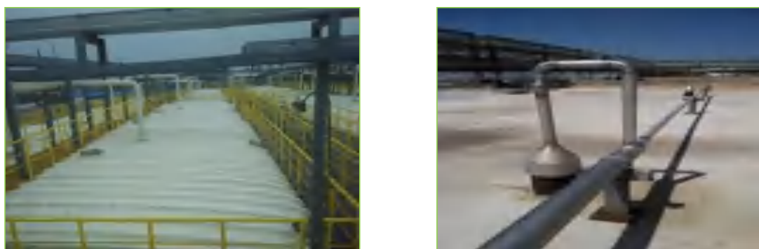
图 2.2-7 污水处理系统、污水池废气收集设施
