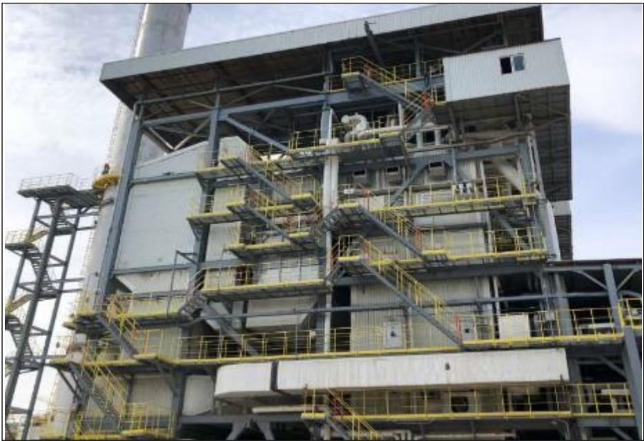
图 2.2-2 废能锅炉外貌图
