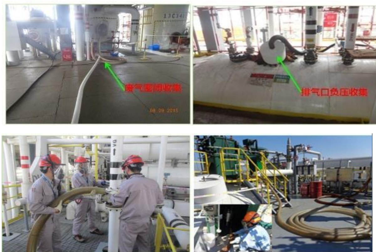
图 2.2-5 检修时废气软管收集设施
