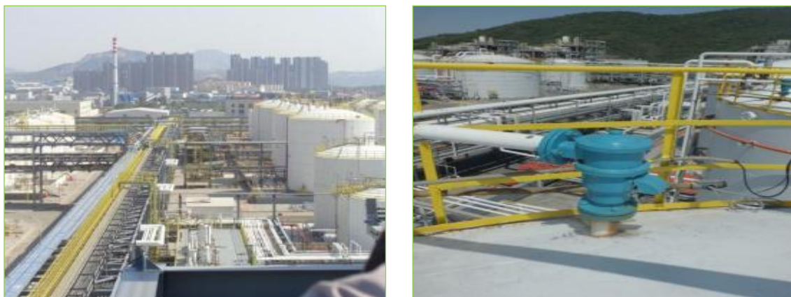
图 2.2-4 储罐安全阀排气收集
