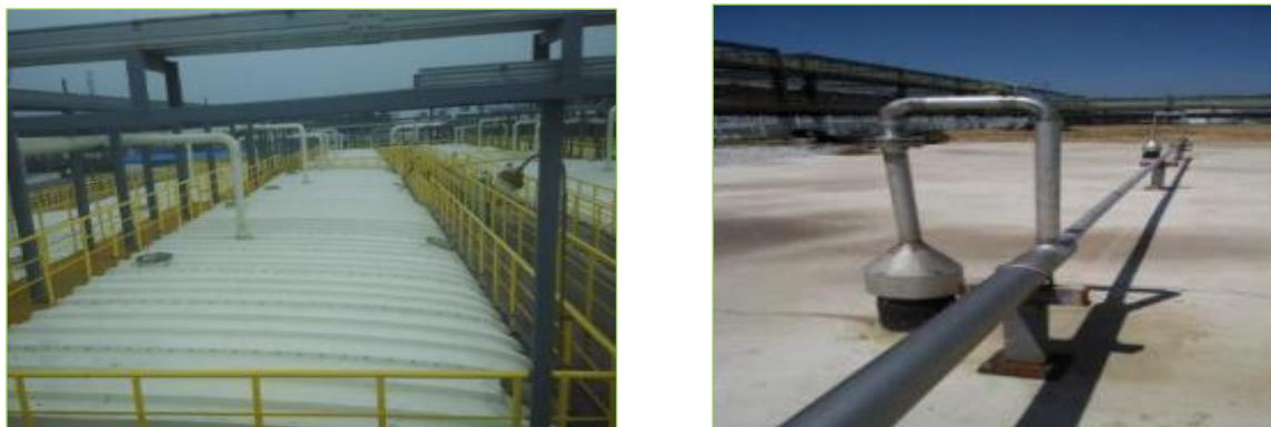
图 2.2-7 污水处理系统、污水池废气收集设施
