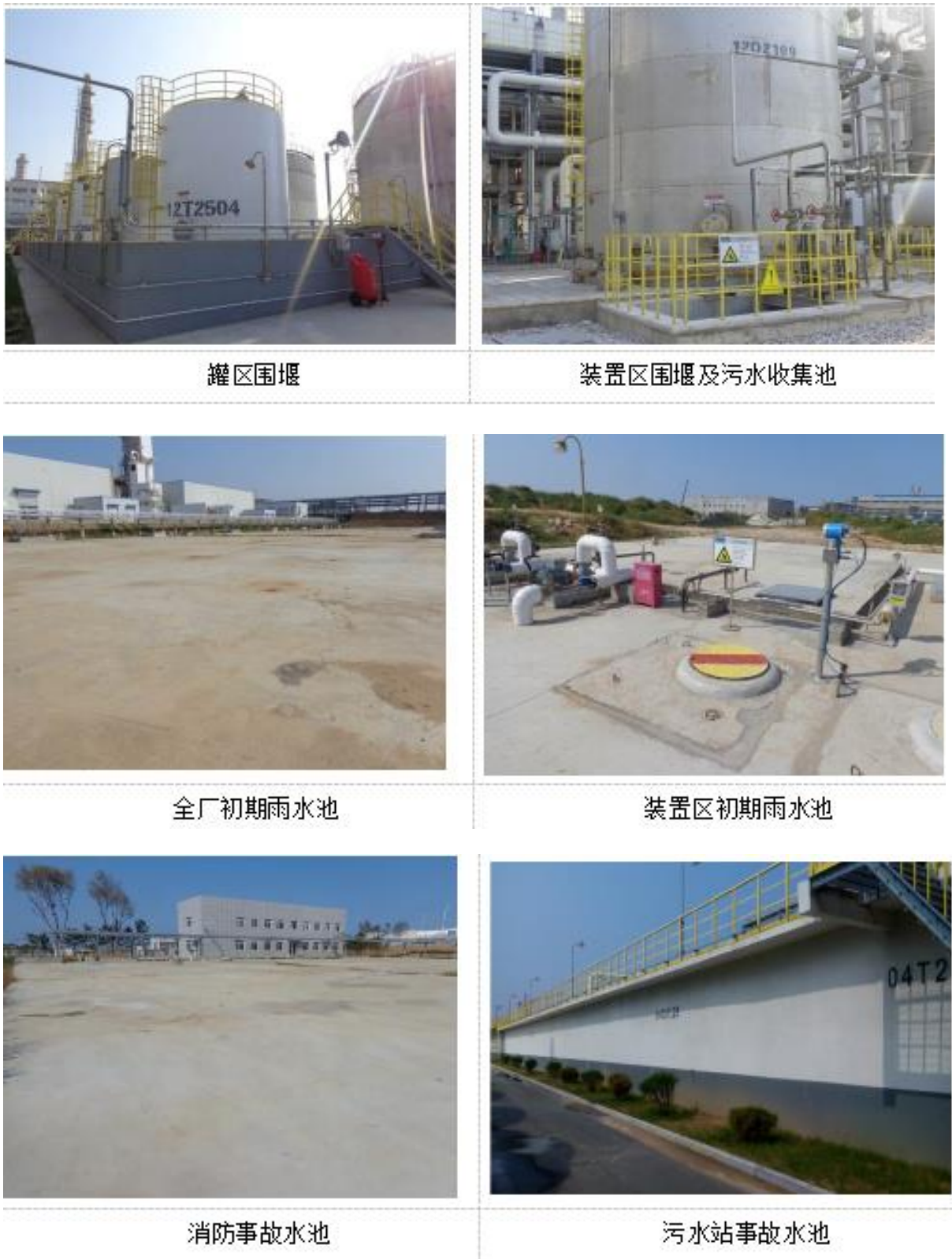
图 10.2-2 现有工程废水风险防范措施
