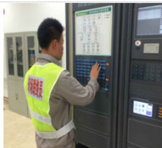
打开控制室消防柜现场雨淋阀开关
