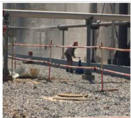
事故废水切换至消防事故池
