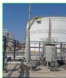
苯罐区活性炭吸附装置
