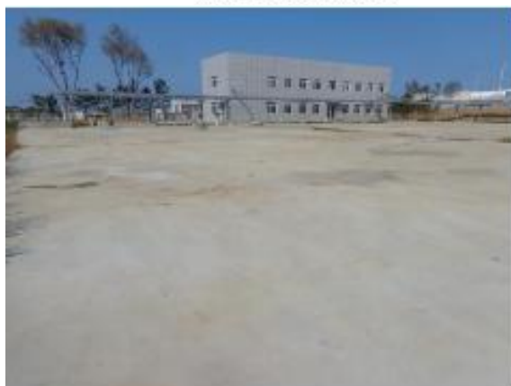
消防事故水池
