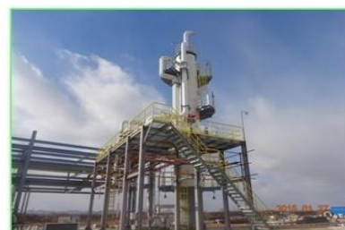
醇罐区水吸收装置
