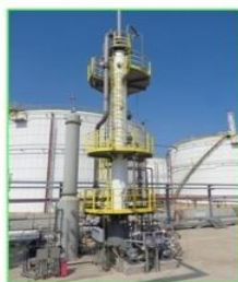
甲醇水洗装置
