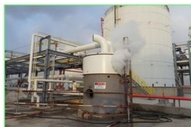
叔丁醇罐区水吸收罐
