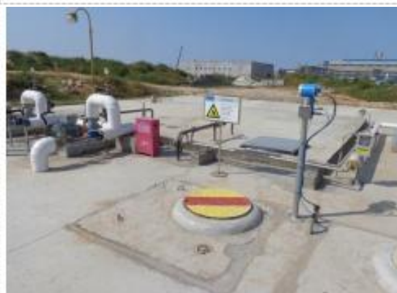
装置区初期雨水池
