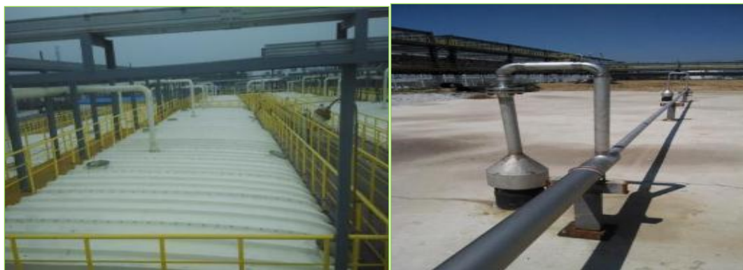
图 2.2-7 污水处理系统、污水池废气收集设施
