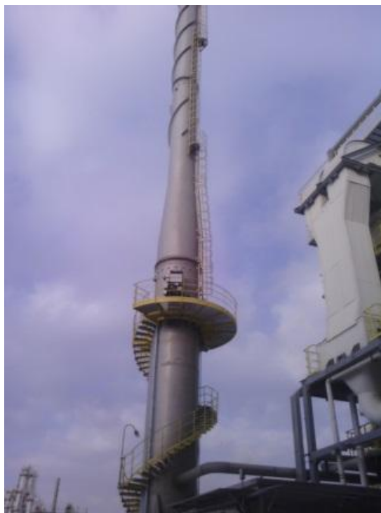
图 2.2-3 1#MMA 废水焚烧炉外貌图
