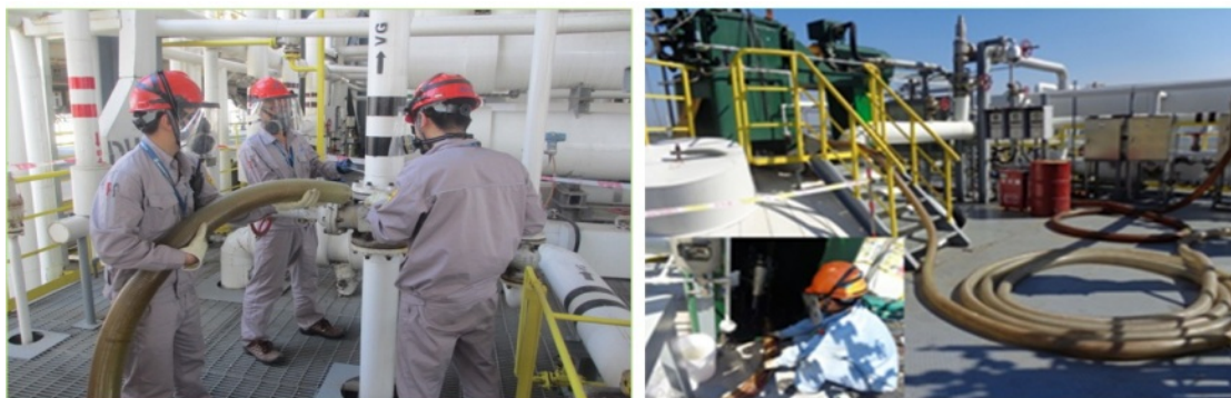
图 3.2-2 检修时废气软管收集设施
