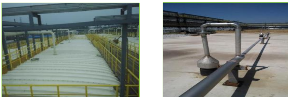
图 3.2-4 污水处理系统、污水池废气收集设施
