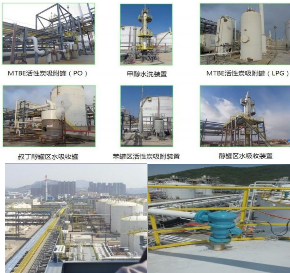
图 3.2-1 储罐安全阀排气收集
