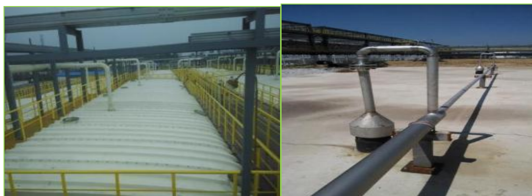
图 3.2-4 污水处理系统、污水池废气收集设施
