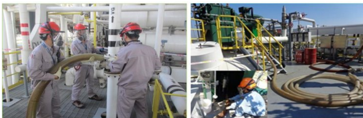
图 3.2-2 检修时废气软管收集设施
