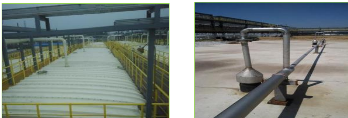
图 2.2-7 污水处理系统、污水池废气收集设施
