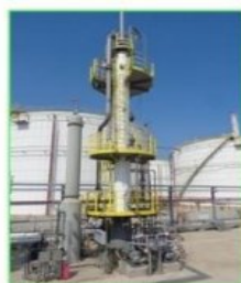
甲醇水洗装置
