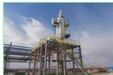
醇罐区水吸收装置
