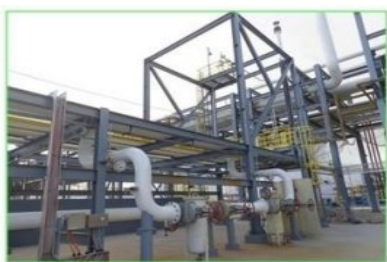
MTBE活性炭吸附罐 ( PO )
