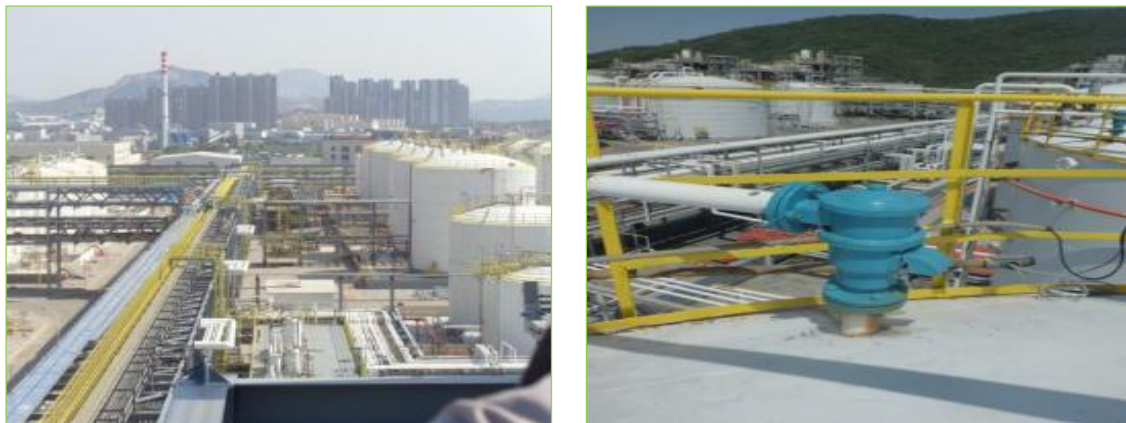
图 2.2-4 储罐安全阀排气收集
