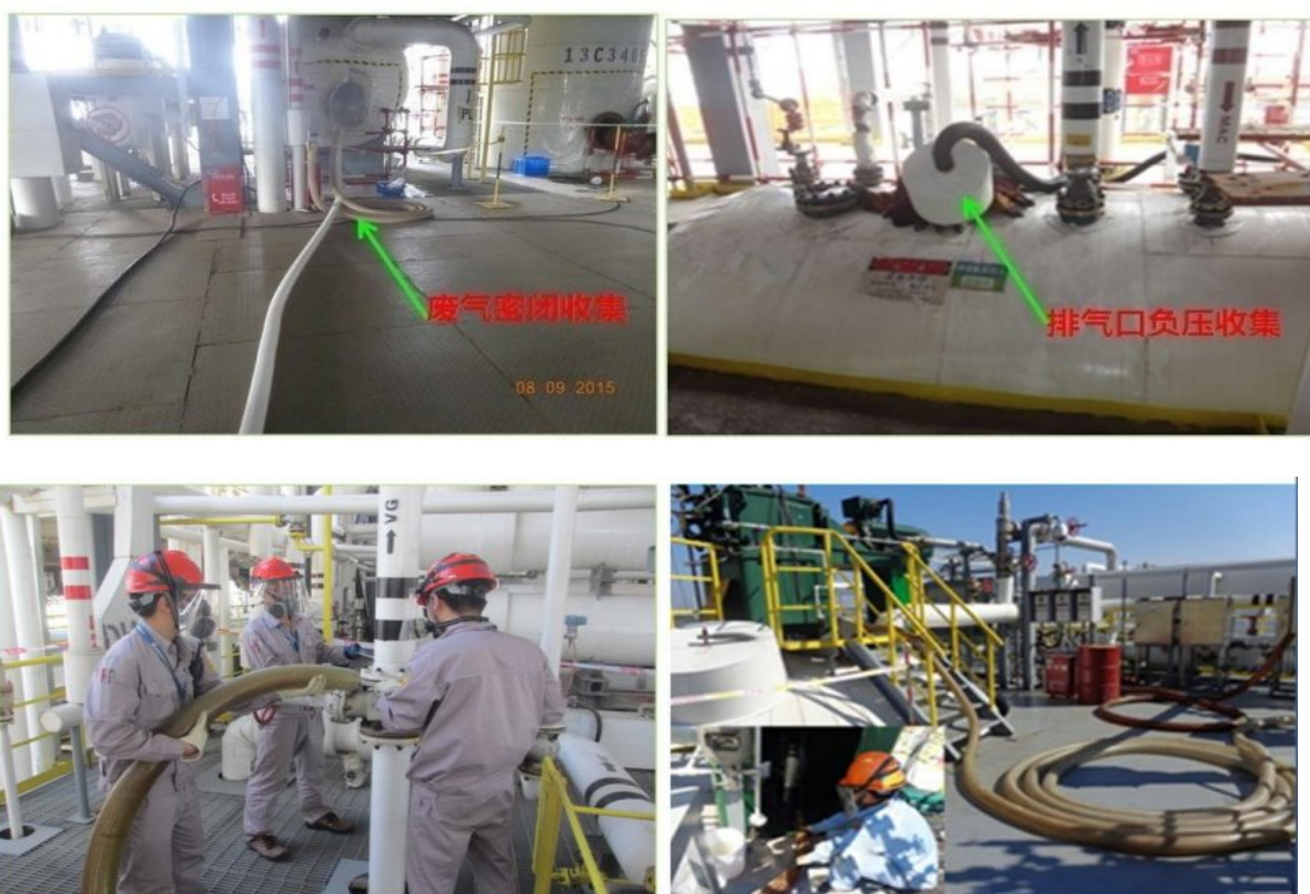
图 2.2-5 检修时废气软管收集设施
