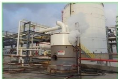
叔丁醇罐区水吸收罐
