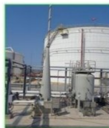
苯罐区活性炭吸附装置
