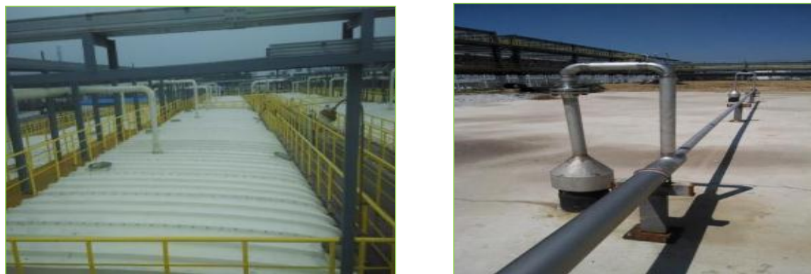
图 2.2-7 污水处理系统、污水池废气收集设施
