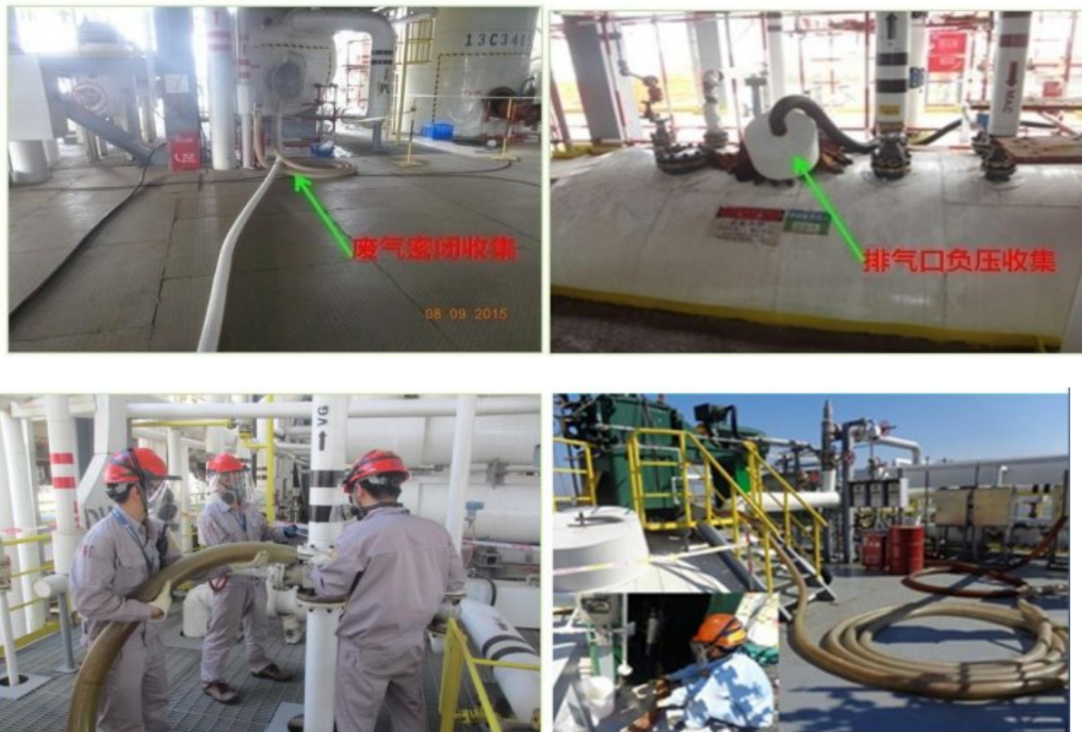
图 2.2-5 检修时废气软管收集设施
