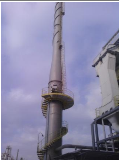
图 2.2-3 1#MMA 废水焚烧炉外貌图
