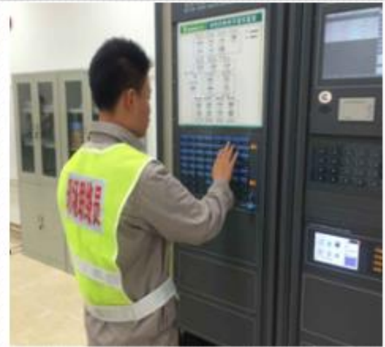
打开控制室消防柜现场雨淋阀开关
