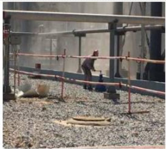
事故废水切换至消防事故池
