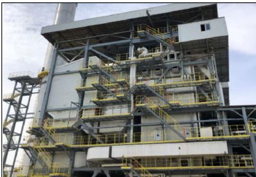
图 10.2-3 万华化学集团环保科技有限公司废能锅炉外貌图
