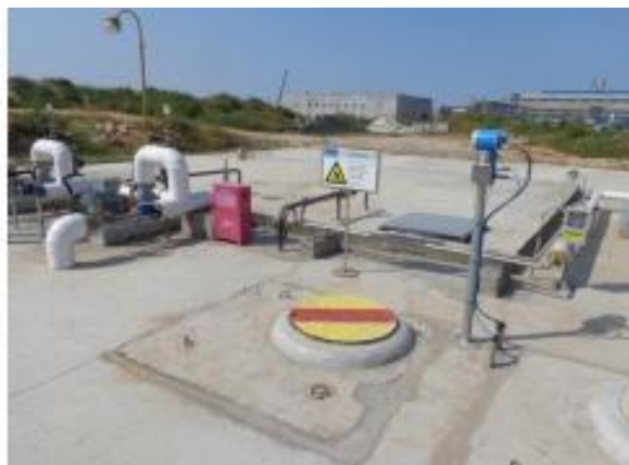
装置区初期雨水池
