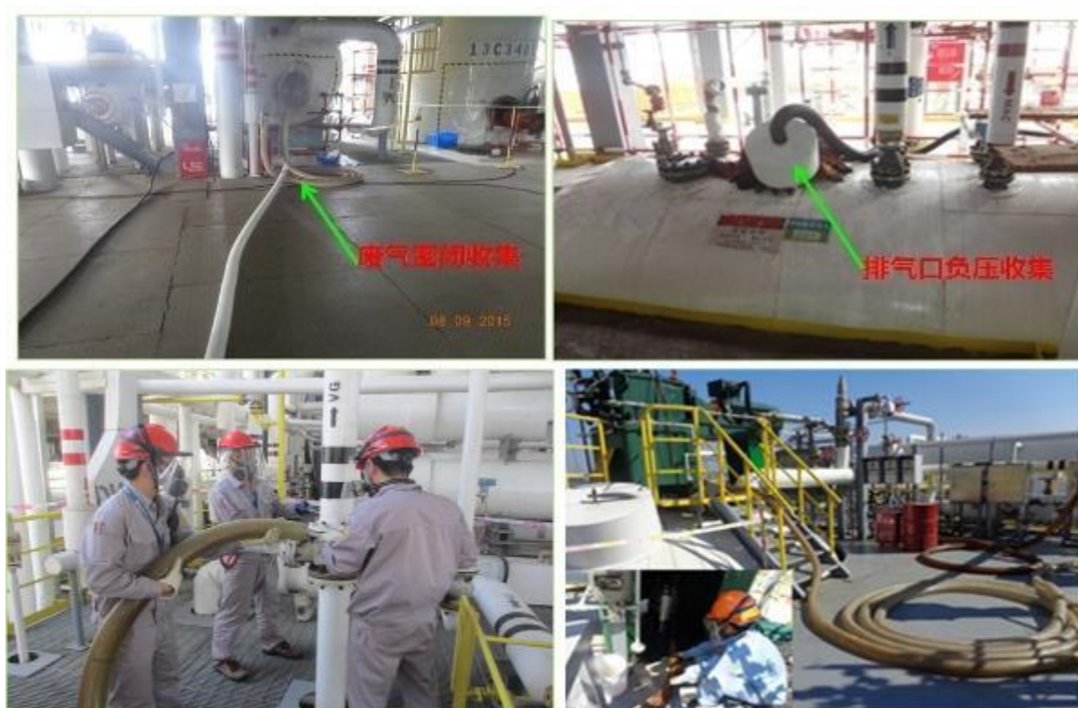
图 2.2-5 检修时废气软管收集设施
