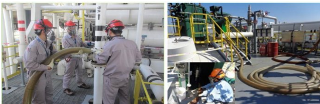
图 3.2-2 检修时废气软管收集设施
