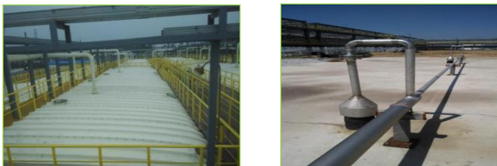
图 3.2-4 污水处理系统、污水池废气收集设施
