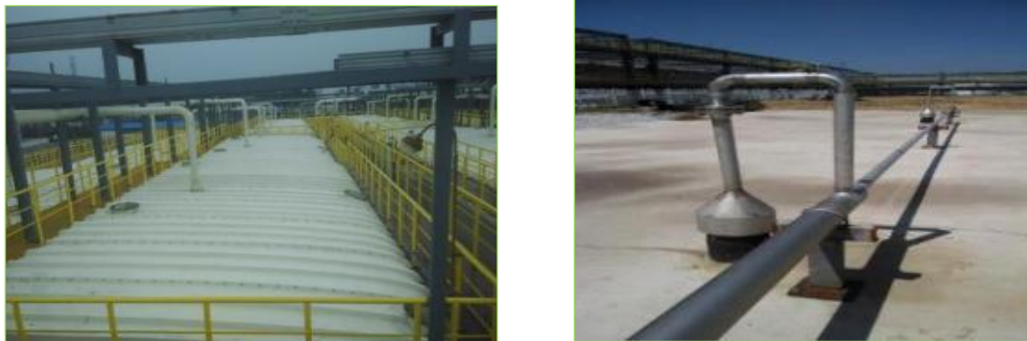
图 2.2-7 污水处理系统、污水池废气收集设施
