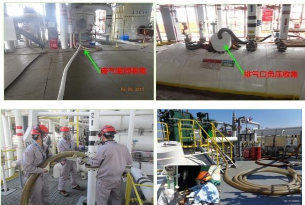
图 2.2-5 检修时废气软管收集设施
