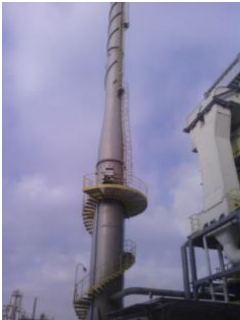
图 2.2-3 1#MMA 废水焚烧炉外貌图 1#MMA 废水焚烧炉现有处理情况见表 2.2-10。
