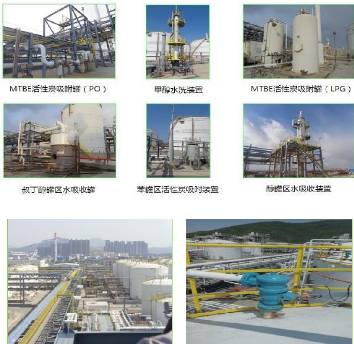
图 2.2-4 储罐安全阀排气收集
