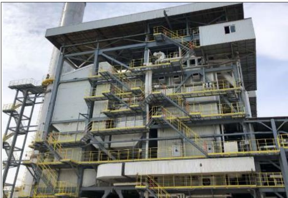
图 2.2-2 废能锅炉外貌图 表 2.2-9 废能锅炉处理情况表
