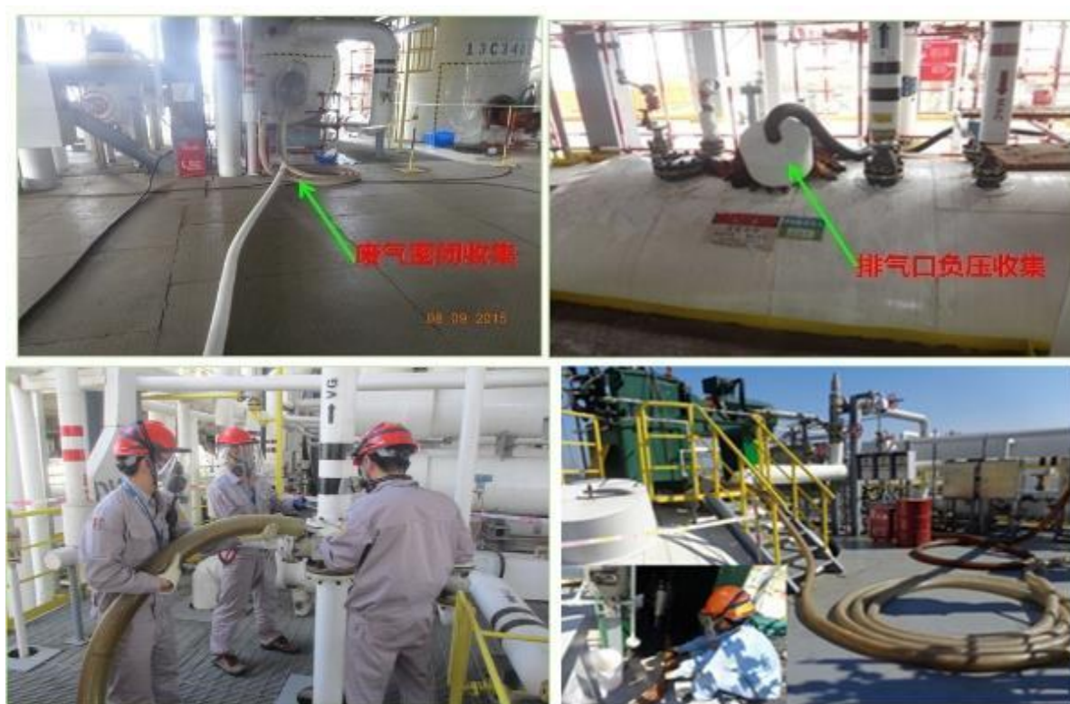
图 2.2-5 检修时废气软管收集设施
