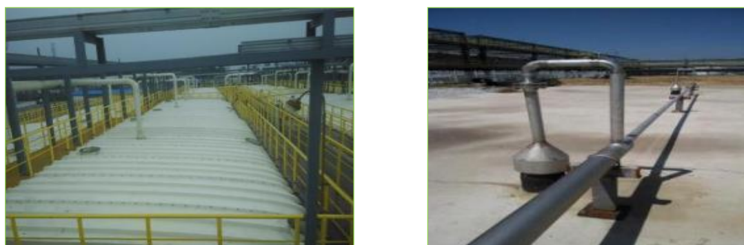
图 2.2-7 污水处理系统、污水池废气收集设施
