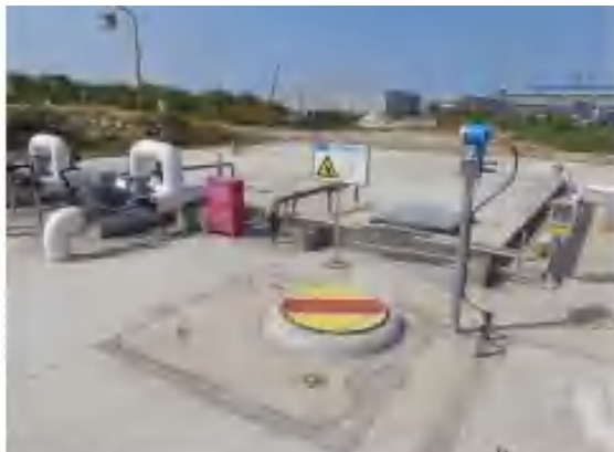
装置区初期雨水池
