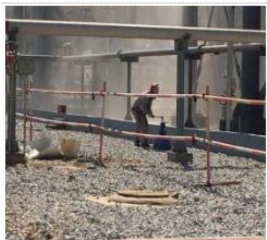
事故废水切换至消防事故池
