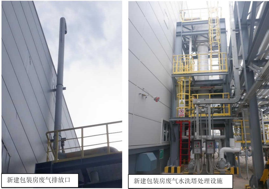
图2.2-18 现有部分废气治理设施现状图
