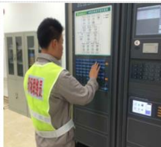
打开控制室消防柜现场雨淋阀开关
