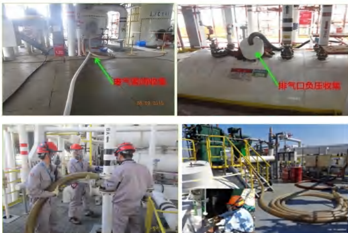
图 3.2-5 检修时废气软管收集设施
