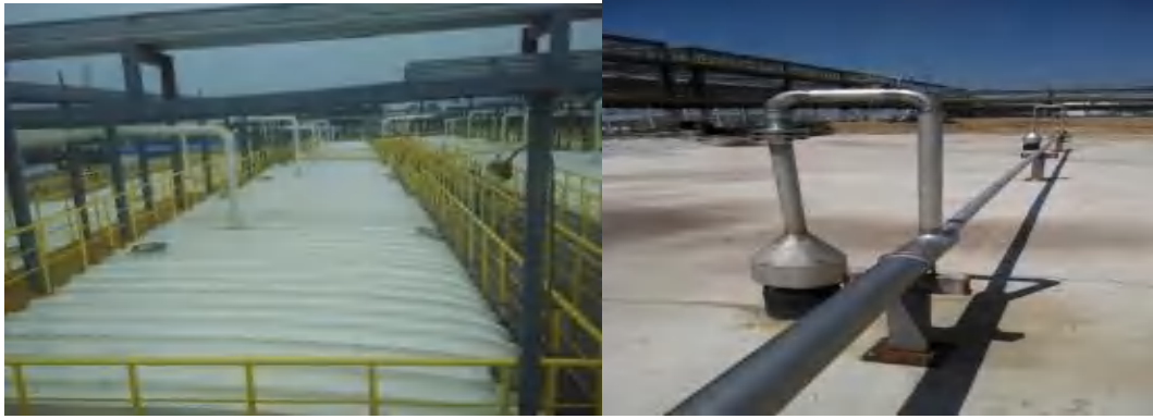
图 3.2-7 污水处理系统、污水池废气收集设施
