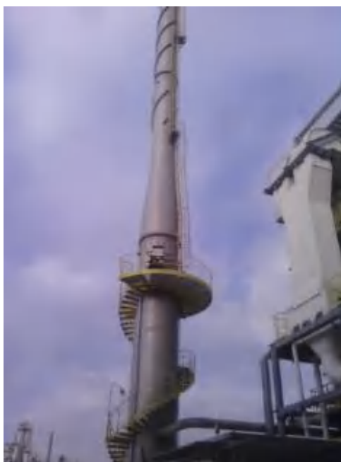
图 3.2-3 1#MMA 废水焚烧炉外貌图
