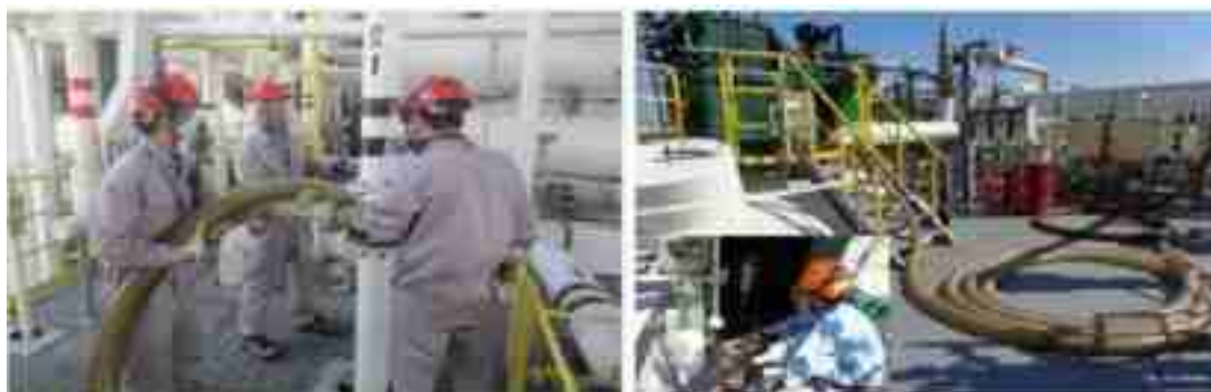
图 2.2-5 检修时废气软管收集设施
