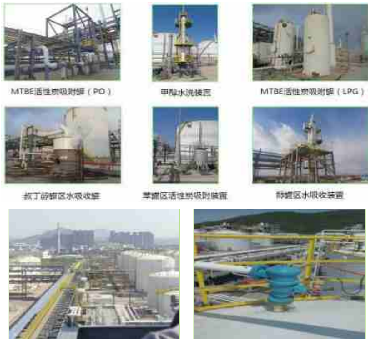
图 2.2-4 储罐安全阀排气收集
