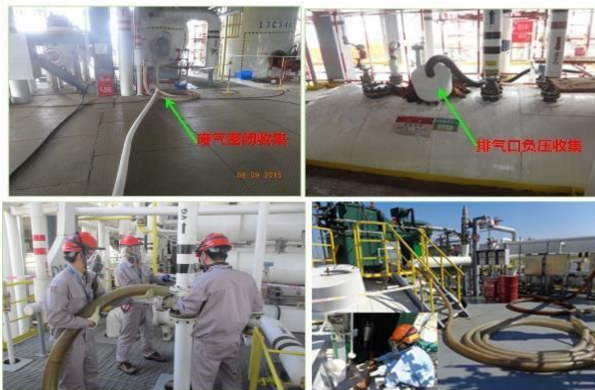
图 2.2-5 检修时废气软管收集设施
