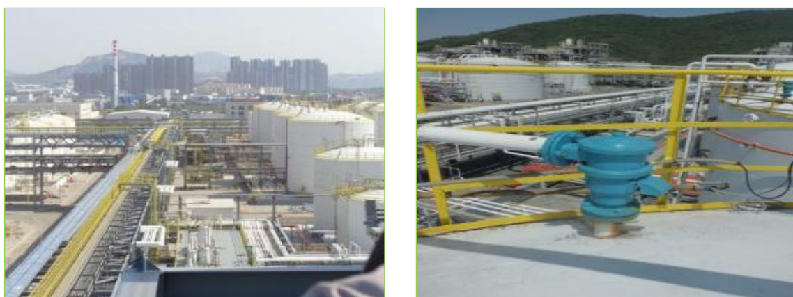
图 2.2-4 储罐安全阀排气收集
