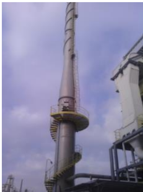
图 2.2-3 1#MMA 废水焚烧炉外貌图
