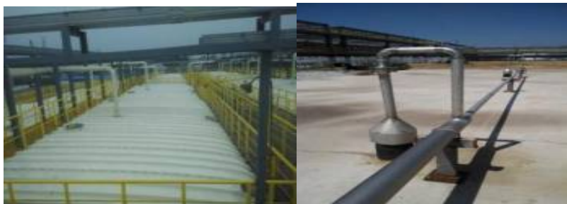
图 3.2-7 污水处理系统、污水池废气收集设施
