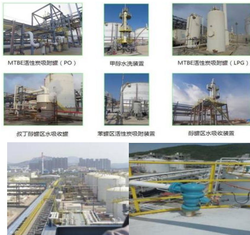
图 3.2-4 储罐安全阀排气收集
