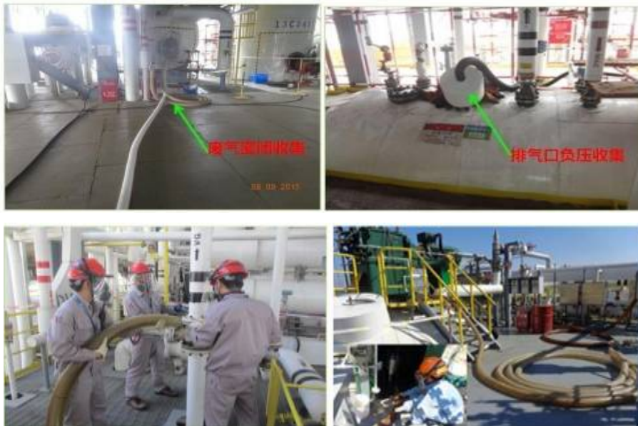
图 3.2-5 检修时废气软管收集设施
