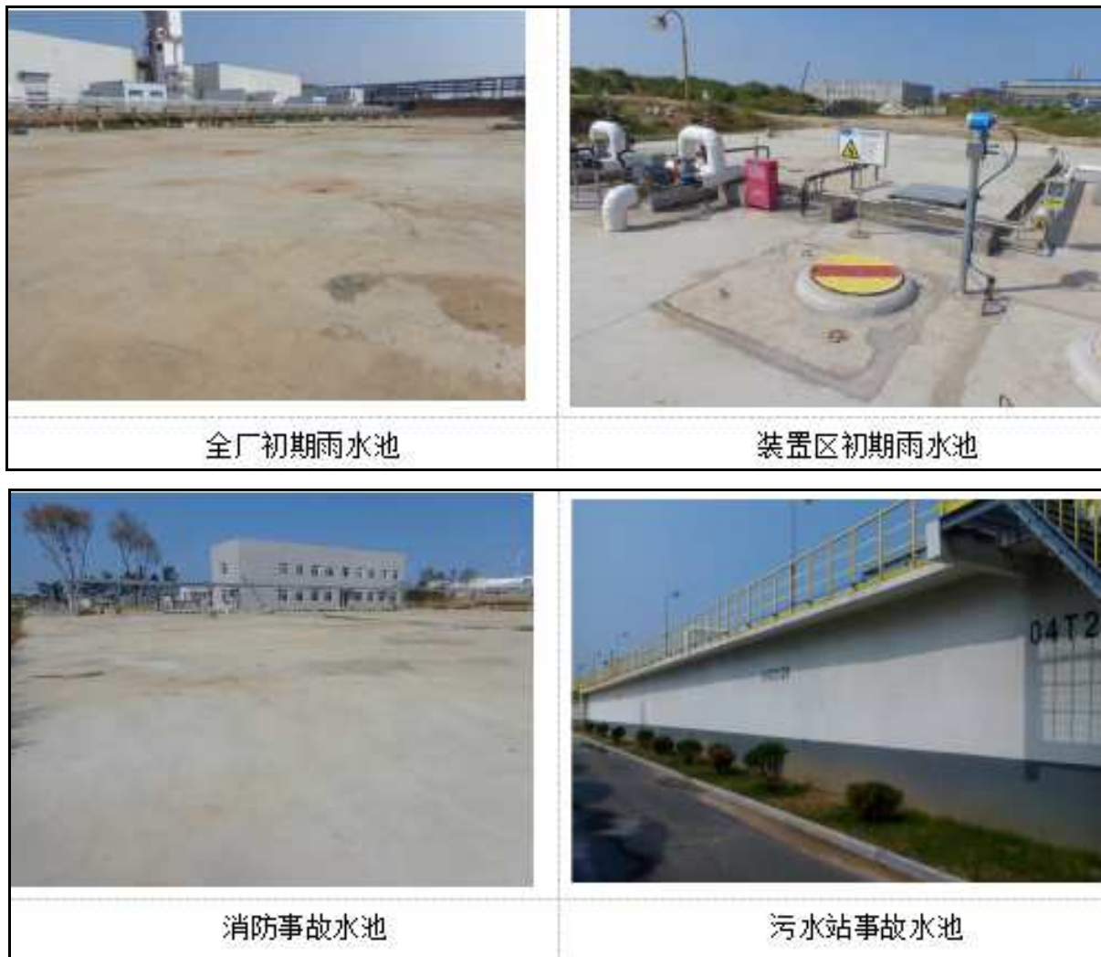
图 7.1-2 现有工程水环境风险防范设施
