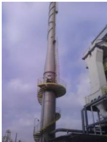
图 3.2-3 1#MMA 废水焚烧炉外貌图
