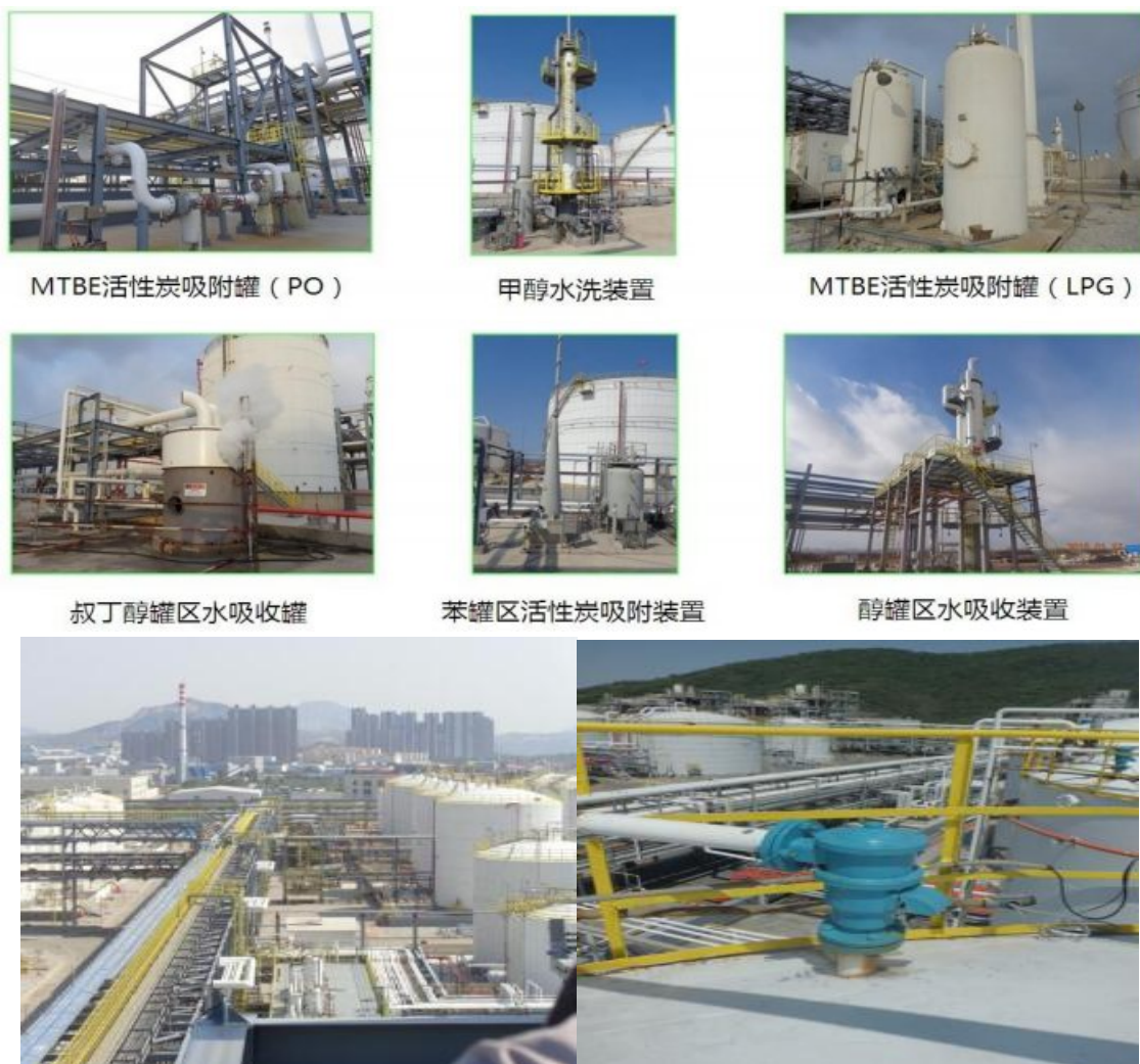
图 3-5 储罐安全阀排气收集
