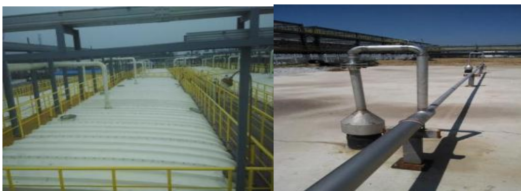
图 3-8 污水处理系统、污水池废气收集设施
