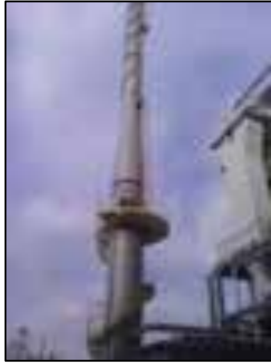
图 2.2-3 1#MMA 废水焚烧炉外貌图
