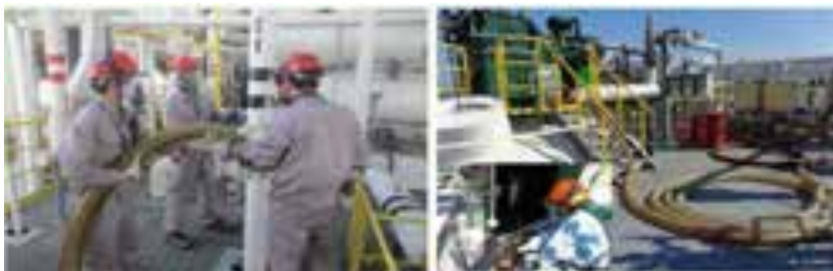
图 2.2-5 检修时废气软管收集设施
