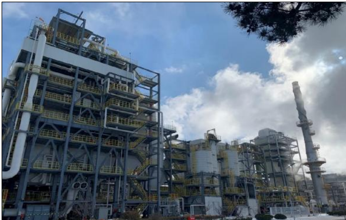
图 10.2-5 拟建项目依托的 TDI 能量回收焚烧炉外貌图
