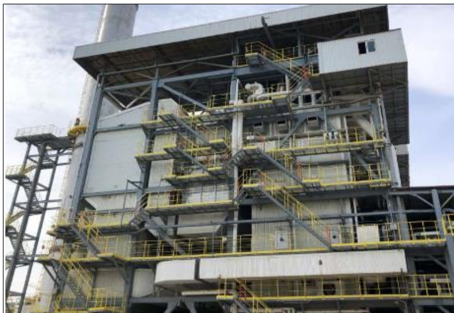
图 2.2-2 废能锅炉外貌图
