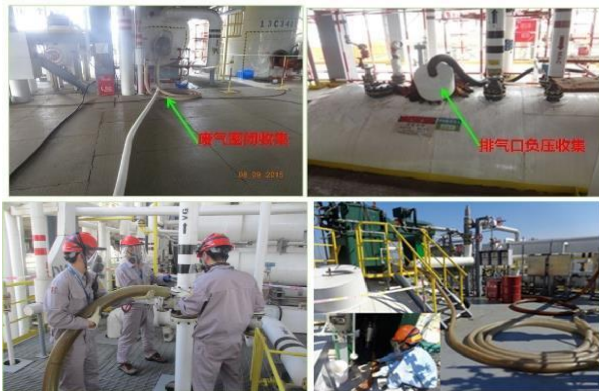
图 2.2-5 检修时废气软管收集设施
