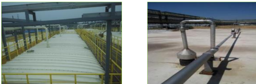
图 2.2-7 污水处理系统、污水池废气收集设施
