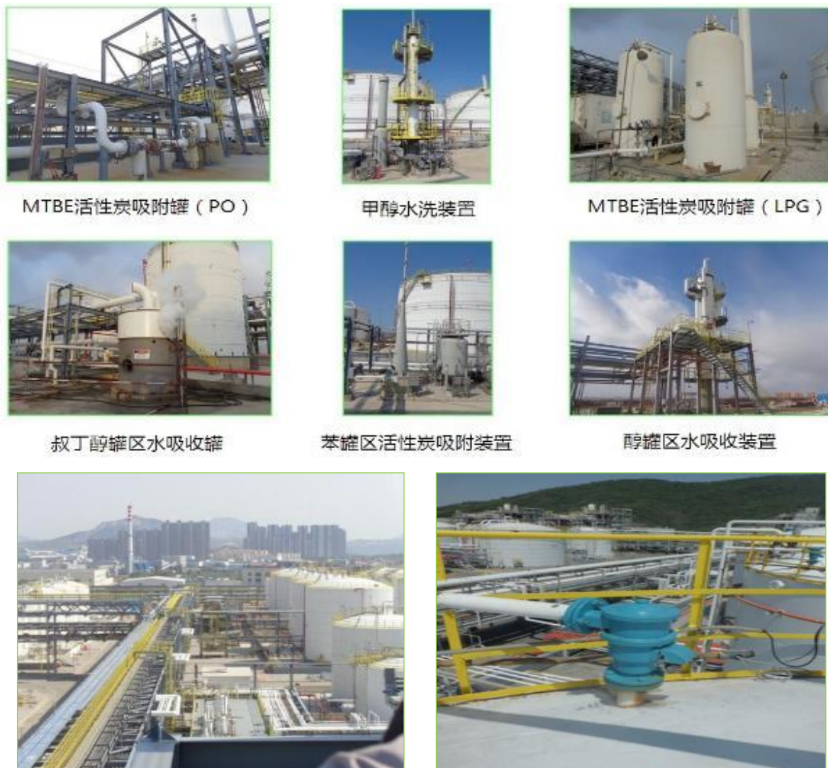
图 2.2-4 储罐安全阀排气收集
